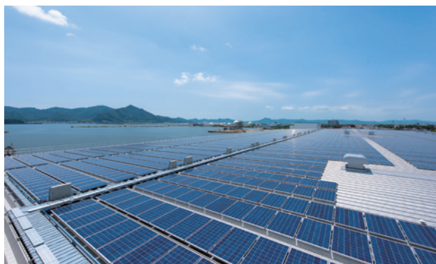
物流センターの建物上部にある太陽光発電設備
